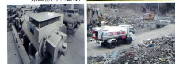
非常用発電機
